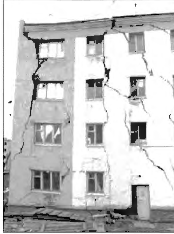
دُمر المبنى السكني السيبيري عندما أضعف الجمد الدائم الذائب القوة البنيوية للأرض القائمة تحته. وبعد أيام من ظهور التشققات الأولى، انهار المبنى.
